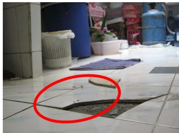
Gambar 6. Kemiringan dan kerusakan keramik
