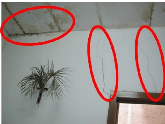
Gambar 8. Rembesan air pada plafon dan dinding retak
