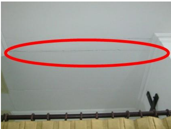
Gambar 9. Kerusakan pada plafon
