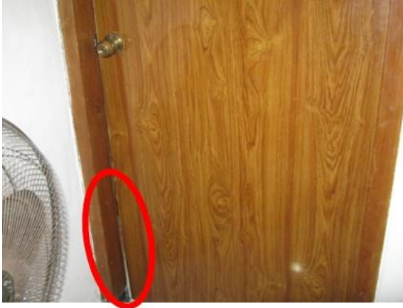
Gambar 7. Celah pada kusen pintu
