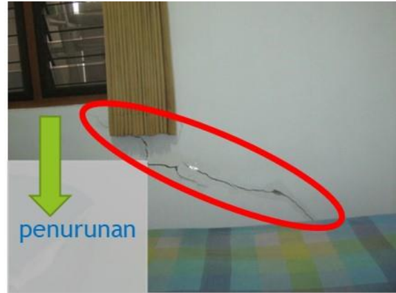
Gambar 5. Keretakan dinding kamar akibat penurunan sisi kiri Rumah 2
