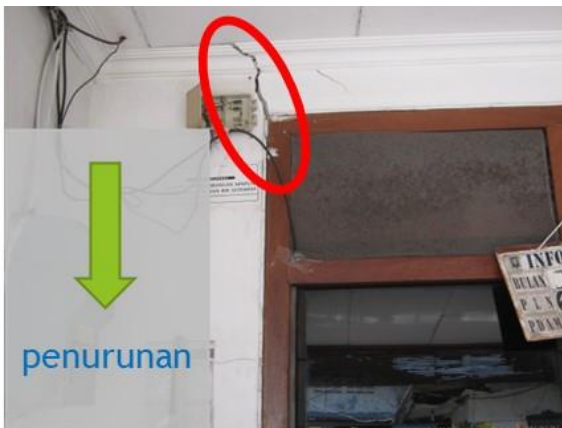
Gambar 3. Keretakan dinding depan rumah akibat penurunan sisi kanan Rumah 1
