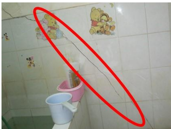
Gambar 4. Keretakan dinding kamar mandi akibat penurunan sisi kanan Rumah 1
