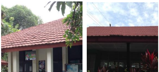
Gambar 10. Hasil Pemeriksaan Kerusakan Pada Atap yang Bergelombang
