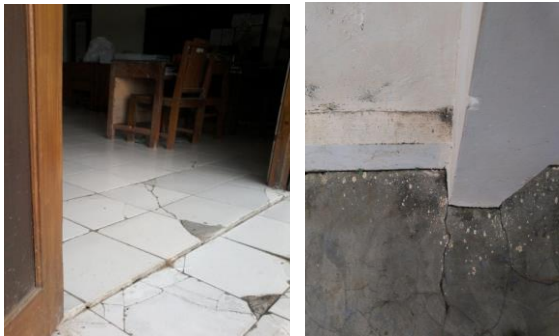
Gambar 9. Hasil Pemeriksaan Kerusakan Pada Lantai
