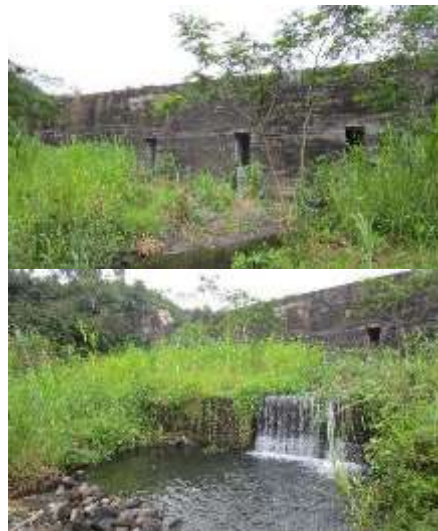
Gambar 4. Contoh Sabo Dam kondisi rusak ringan
