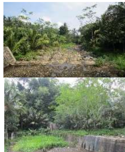
Gambar 5. Contoh Sabo Dam kondisi rusak sedang
